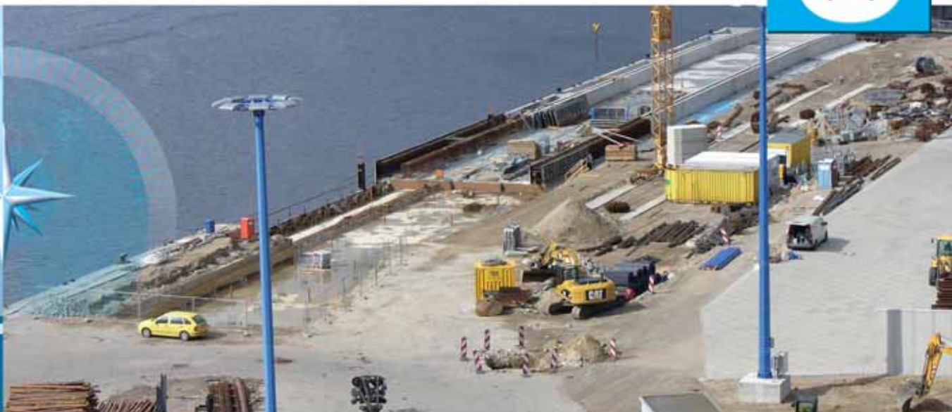
Die Bauarbeiten im Hafen sind im vollen Gange, hier im Bereich des Liegeplatzes 2.
